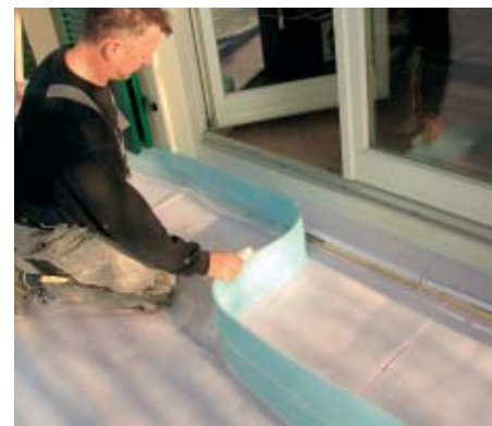
3. Um den Gefälleestrich zu entkoppeln, wurde vor der Terrassentür und zur Hauswand hin ein Randdämmstreifen eingebaut.
