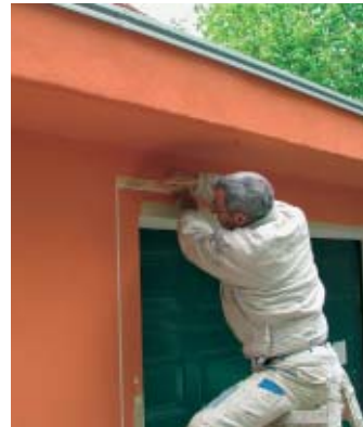
21. Der Baukörper unterhalb der Terrasse wurde gestrichen und mit feinen Schmucklinien versehen.
