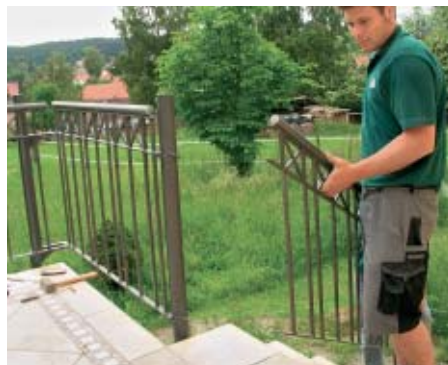
34. Nun wurde das im erforderlichen Neigungswinkel vorbereitete Treppengeländer an die abgeschrägte Haltetasche des Eckpfostens ...
