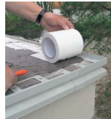
10. Der Profilschenkel wurde mit der Schlämme abgedichtet, ein Dichtband aus frischem Material eingearbeitet.
