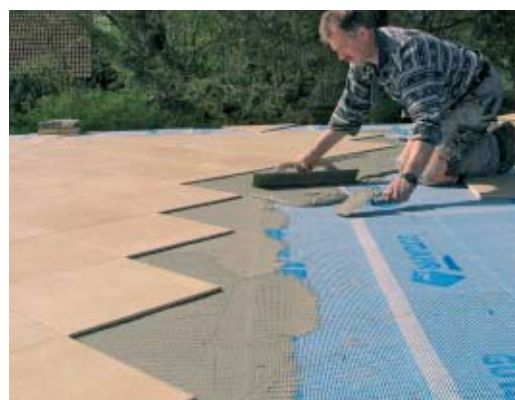
13. Abschnittsweise wurde die Matte mit flexiblem Fliesenkleber ausgespachtelt, dann mit der gezahnten Seite der Kelle Kleber aufgekämmt und die Fliesen ...
