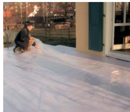
2. Darauf wurde lose eine reißfeste Kunststoffdichtungsbahn überlappend ausgelegt und mit Klebebändern dicht verklebt.
