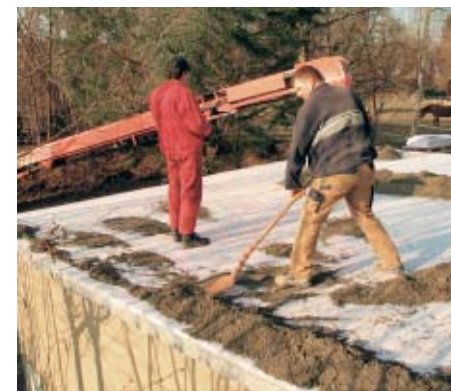
4. Das Material für den Gefälleestrich wurde angeliefert, maschinell auf das Garagendach gefördert und dort von Hand gleichmäßig verteilt.
