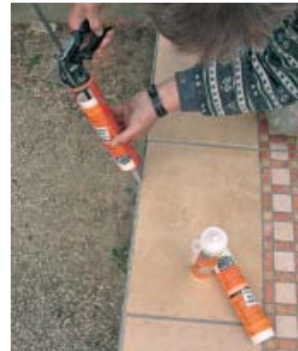
20. ... ebenso die ausgekrazte Fuge zwischen den Randfliesen und dem Abschlussprofil.
