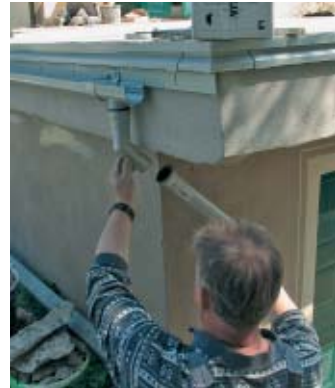
18. ... vorn am tiefsten Punkt ein Rinnenablaufelement, ein Rohrbogen und ein Fallrohr angebracht.
